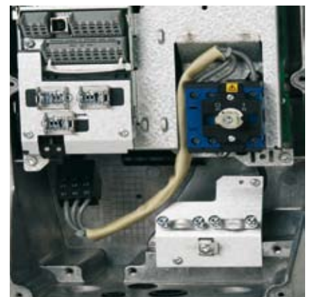
Die Dimensionierung und Aufteilung des Anschlusses ermöglicht eine schnelle und einfache Verdrahtung.
